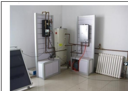
Chauffage et chauffe eau solaire
